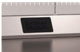
10: 3 prises électriques 12A pour un circuit électrique de 15A.
