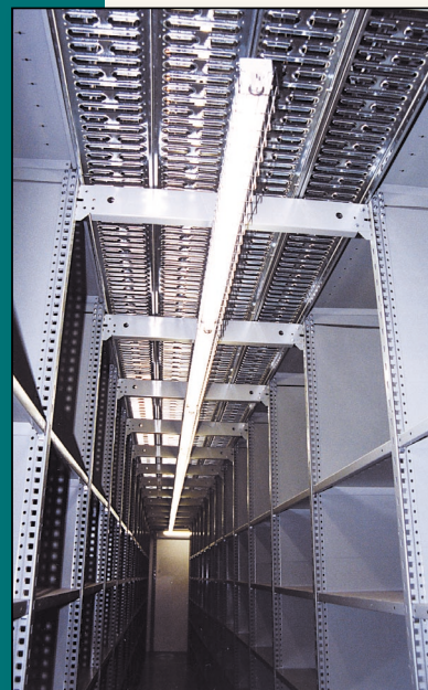
Très sécuritaire, le plancher à la mezzanine sert également de plafond au premier niveau.
