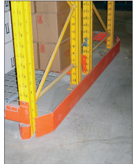
Au sol, on aperçoit les rails de protection sur les palettiers contre les impacts.
